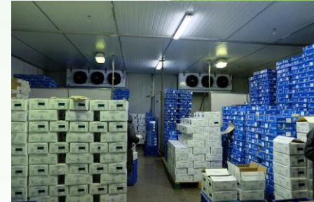
Chill Room Divisi Pasteurisasi
